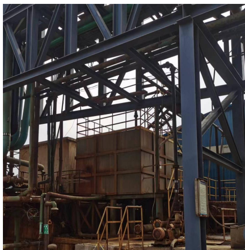
水处理药剂储罐
