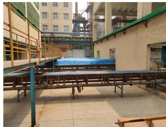
散装物料封闭运输带
