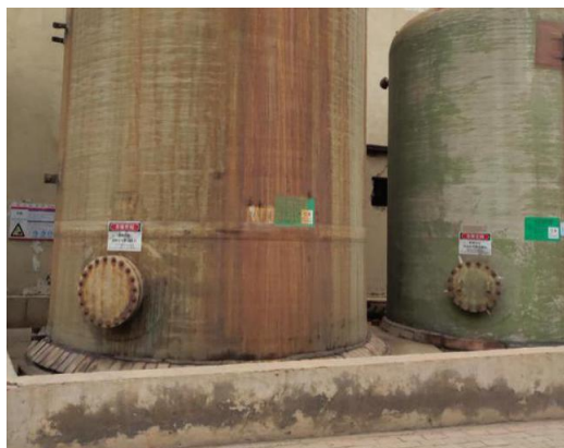
盐酸应急收集设施
