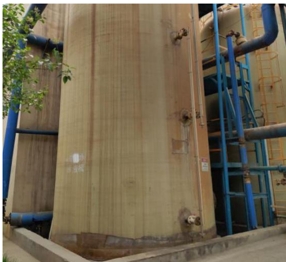
酸性废水储罐
