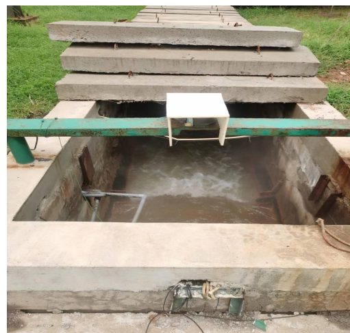
废水总排放口
